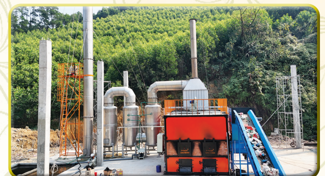
Lò đốt rác T-TECH có quy mô phù hợp, đáp ứng quy chuẩn khí thải, tro xỉ.
