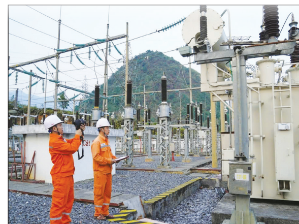
Xí nghiệp lưới điện cao thế Lai Châu kiểm tra vận hành trạm biến áp 110kV.
